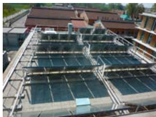
Figura 10 – Campo di collettori solari termici
