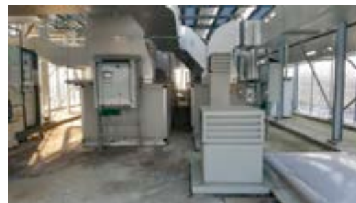
Figura 5 – Particolare delle UTA poste in copertura all'interno dei sistemi di schermanti
