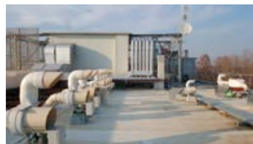
Figura 6 – Particolare delle espulsioni delle cappe
