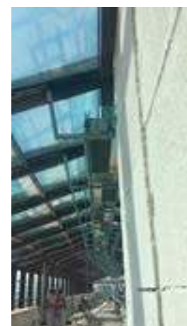
Figura 9 – Hotel The Britannique: gli impianti nella zona roof
