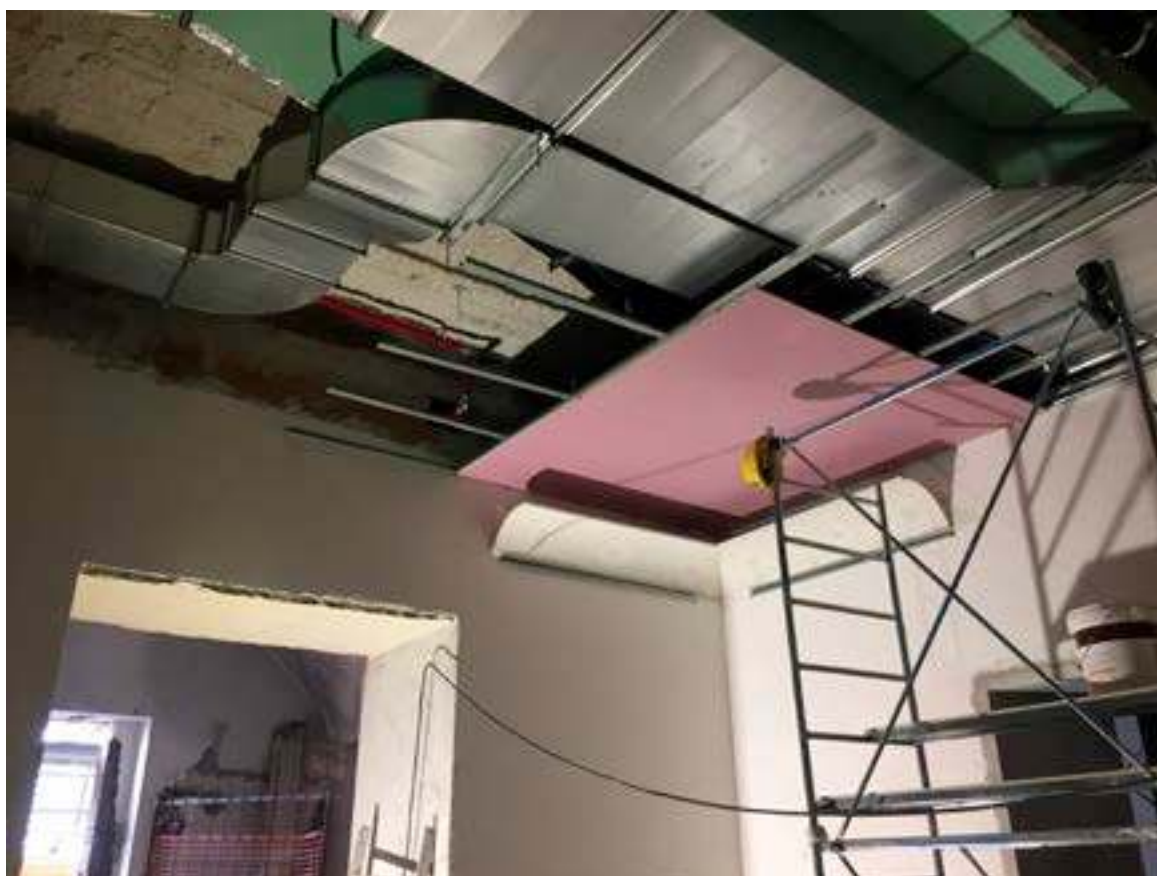
Figura 8 – Hotel The Britannique: gli impianti a soffitto nella hall
