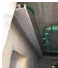
Figura 6 – Hotel The Britannique: Dettaglio della veletta di contenimento degli impianti all'interno della camera
