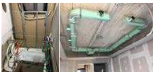
Figura 4 – Hotel The Britannique: condotte aerauliche in una camera
