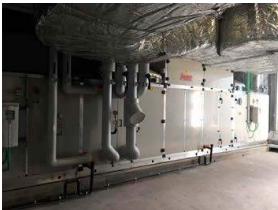
Figura 7 – Unità di trattamento aria installata
